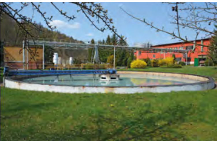
Čistírna odpadní vody
